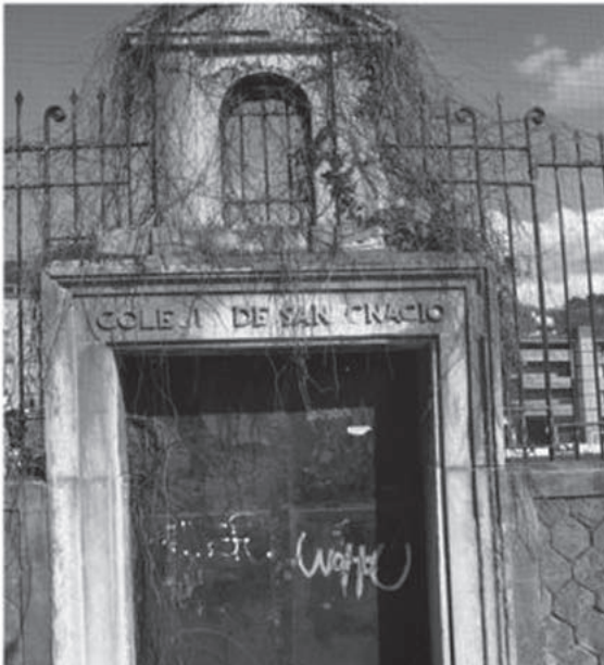
Figura 7. Un mantenimiento descuidado es señal de bajo control informal
